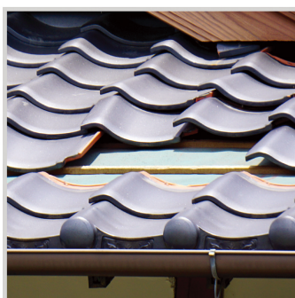
無繫結による脱落やズレ
