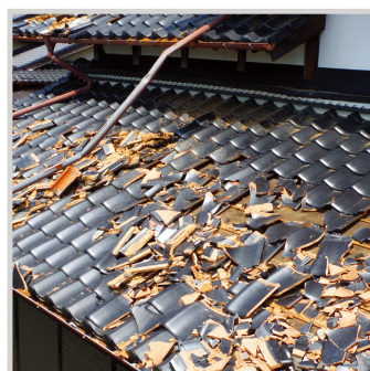
脱落した瓦による二次被害
