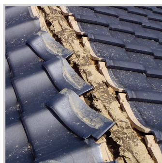
半端瓦の無繫結による脱落
